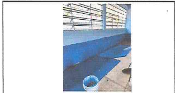
Foto 4: muros que necesitan intervención de aplicación de pintura
