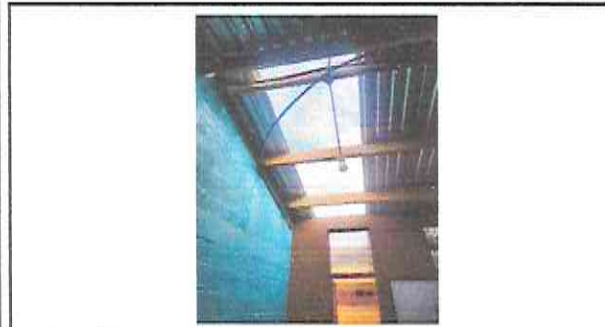
Foto 3: daños en lamina del salon de computo.
