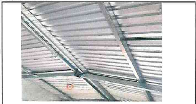
Foto1: Sustitución de estructura de madera por estructura metálica, sustitución de sistema eléctrico
