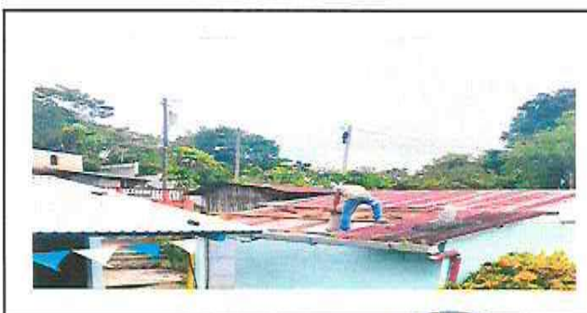
Foto 6: Sustitucion de puerta de metal, sustitucion de canales y bajadas de agua pluvial
