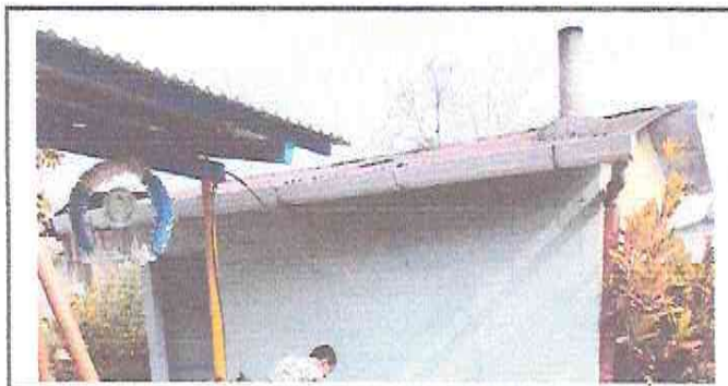
SUSTITUCIÓN DE PUERTA DE METAL, SUSTITUCIÓN DE CANALES Y BAJADAS DE AGUA PLUVIAL ✓
