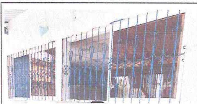
SUSTITUCIÓN DE VENTANAS DE PVC Y SUSTITUCIÓN DE ESTRUCTURA DE METAL DE VENTANA ✓
