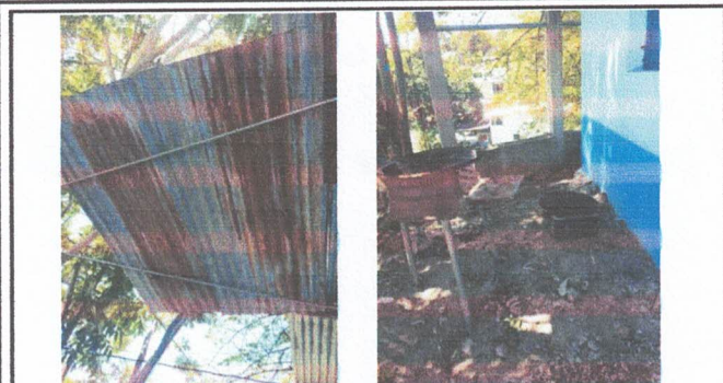
Foto 1: Reparación de Cocina, Polletones, Sustitución de Estructura y Techo de Lamina Troquelada C26 LEGITIMO.
