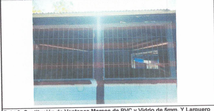
Foto 8: Sustitución de Ventanas Marcos de PVC y Vidrio de 5mm. Y Larguero de Estructura Metalica y Lamina. AULA HEXAGONAL.
