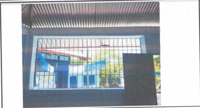
Foto 7: Reparación de Cielo Razo de PVC, Lamparas Led, Ventiladores Y Ventanas Marcos de PVC y Vidrio de 5mm. AULA HEXAGONAL.
