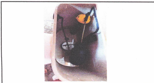
Foto 4: Sustitución de accesorios para sanitario (Contra llave, tubo de abasto y tanque)
