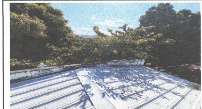
Foto 4: Se debe hacer una marquesina en el techo, para evitar que se filtre la humedad y continúe dañando la pared del aula.
