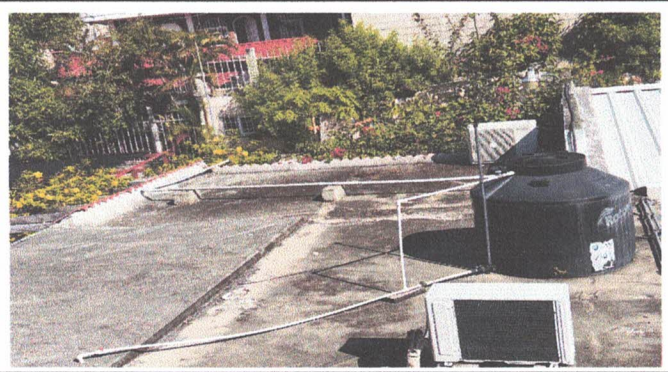
Foto1: Terreza de Dirección del establecimiento, la cual tiene filtración de agua. Y gotea adentro de la dirección.
