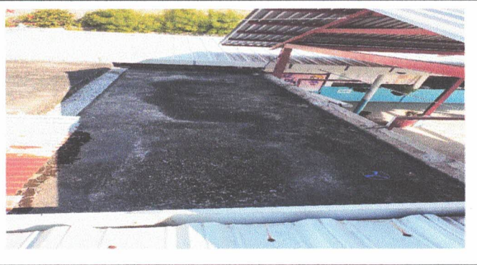
Foto 2: Parte de la terreza del area de Dirección que tiene filtración de agua.
