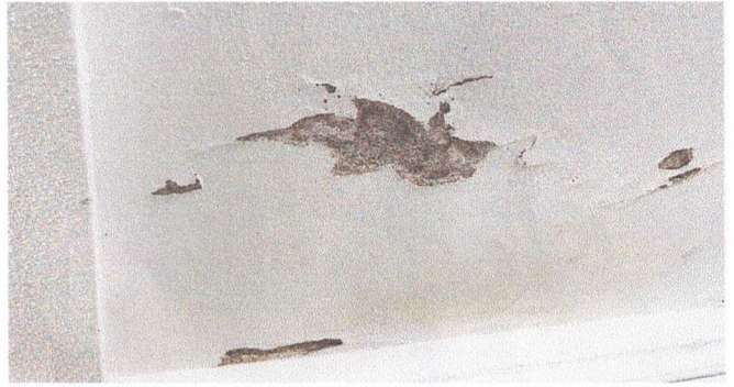
Foto 4: Daños en el techo de adentro de la dirección por el problema de filtración de agua.
