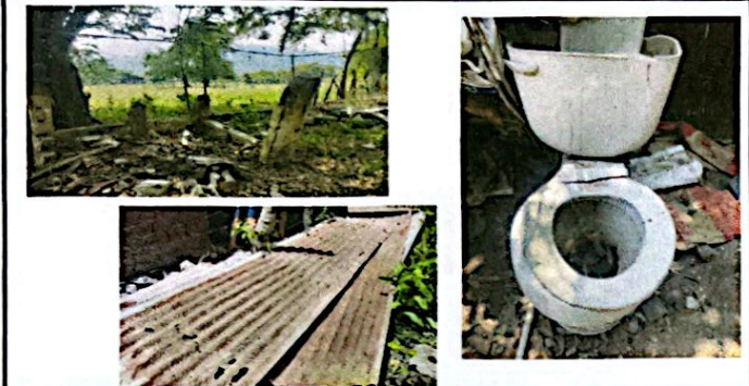
Foto 1 Modulo A baños sustitución de baños en otra area de la esuela ya que donde estaban se hundieron y caerón.
