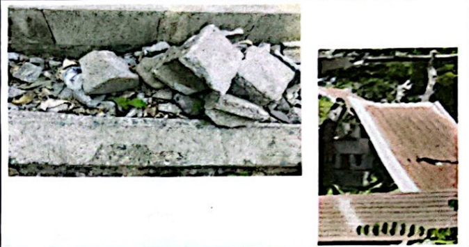
Foto 2 Modulo B Anexo de cocina, se callo por el tiempo de construcción y necesita ser sustituido.
