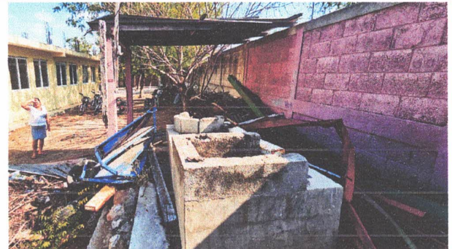
Sustitución de estufa Rural Completa (Polleton, Plancha y Chimenea)
