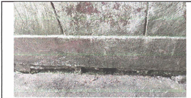
Foto 11: Sustrucción de paredes de block de las aulas con daños en la parte de afuera de las aulas
