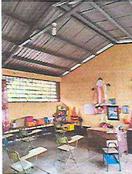
Foto 1: Instalacion de piso tipo ceramico en aula, colocacion de zocalo y pintura general.
