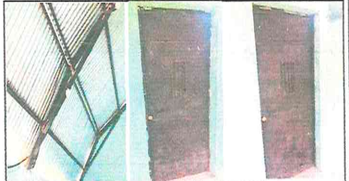
2.3 Sustitución de estructura de soporte de metal por metal. 4.1 Mantenimiento de estructura. 4.2 Sustitución de chapas.
