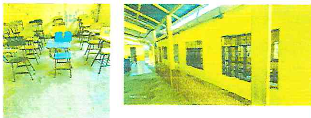
Foto 5: se necesita pintura en muros interiores y exteriores
