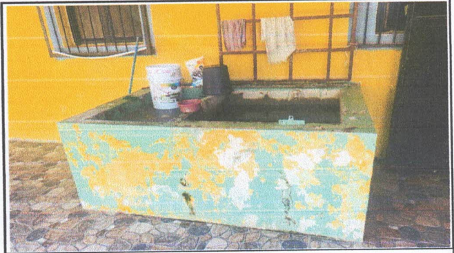
FOTOGRAFIA:DEMOLICION DE PILA EN MAL ESTADO
