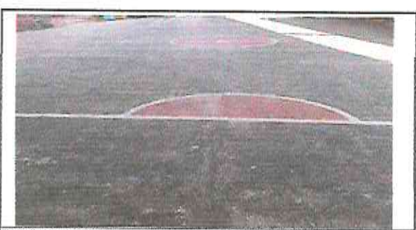
Foto 4.1: Sustrucción de pintura en cancha de basquetbol
