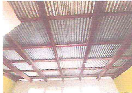
Foto 10. Sustitución de lámina por lámina troquelada aluzinc calibre 26, levantado de muro con block para elevar el techo de lámina, sustitución de estructura de soporte de madera por metal aula 2
