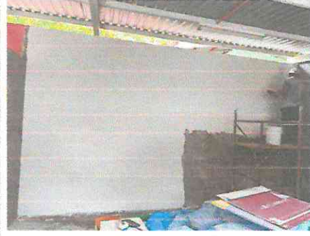
FOTOGRAFÍA No. 2 CERNIDO EN MUROS
