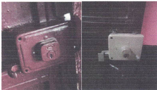
Foto 11. Sustrucción de chapa
