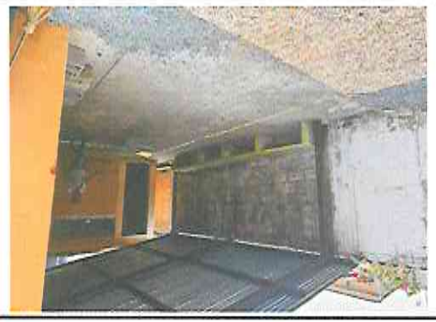
Foto 5: Hay que mejorar las condiciones del área exterior techada aplicando pintura, colocando piso y mejorando la tapadera de una caja de registro existente.
