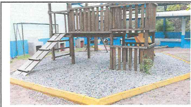
Foto 4: Reparación y Rehabilitación de Area de Juegos con bordillos fundidos y caminamientos. Debidamente Finalizados.
