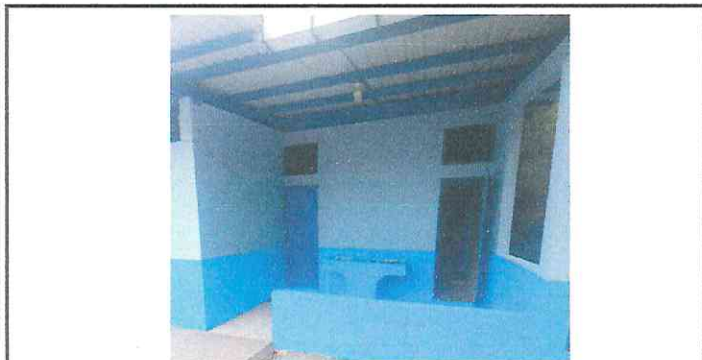
Foto 5: Aula de Primaria y Muros Bajos sin costo alguno.
