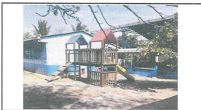
Foto 3: Reparación y Rehabilitación de Area de Juegos con bordillos fundidos y caminamientos.
