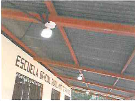
Foto 7: Módulo de corredor con cambio de cableado eléctrico, colocación de plafoneras, interruptores e iluminación.
