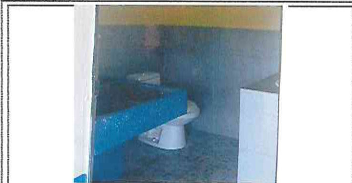
Foto 1: Drenaje de aguas negras y tuberías colocadas, en módulo de baño, con instalación de sanitario, lavamanos y pila.
