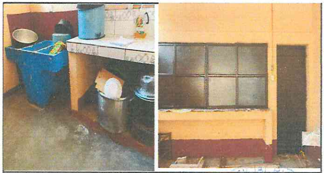
Foto 6: sustitución e instalación de puertas de gabinetes de PVC y instalación de piso ceramico
