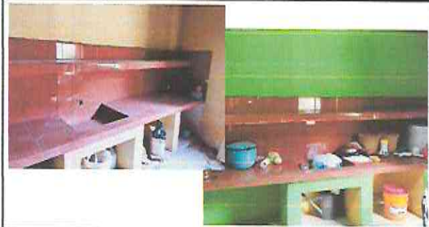
Foto 4: Instalacion de repisa de concreto y azulejo en mueble de cocina existente, pintura en cocina.
