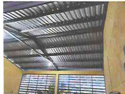
Foto 2: Cambio de lamina con multiples filtraciones.
