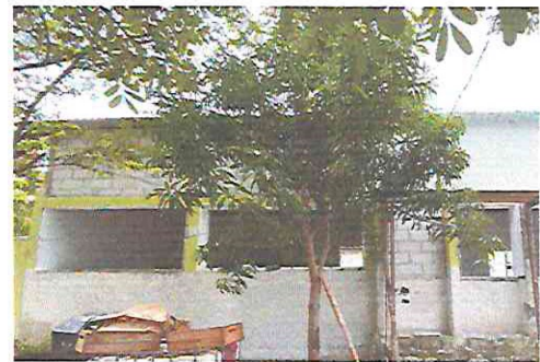
Foto 4. Repello y cernido en muro externo y pintura en aula 1
