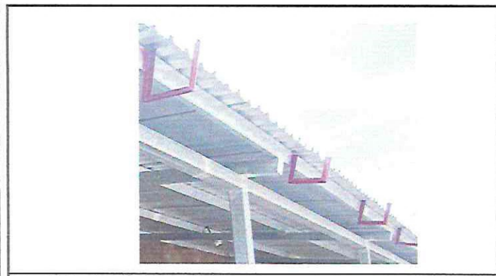
foto 15. Sustitución de canal de metal y soporte de metal para canal en el corredor
