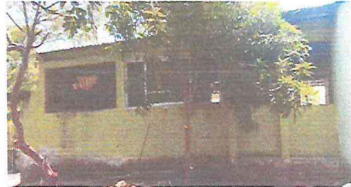
Foto 4. Repello y cernido en muro externo y pintura en aula 1
