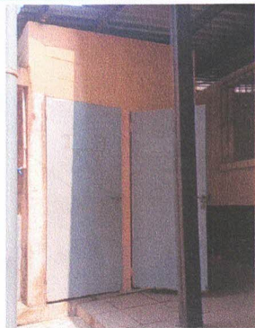
Foto 3: puertas en mal estado, necesitamos mantenimiento de puertas lijado y pintura de buena calidad.
