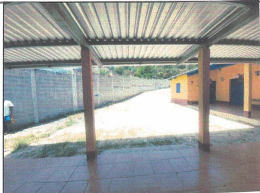
Foto 3: Bajada de Agua canales metalicos, Tubos y codos.
