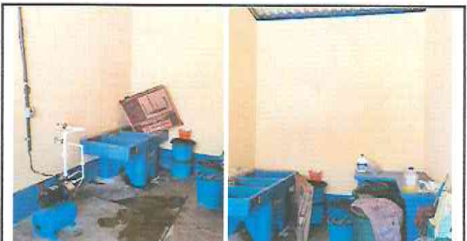
Foto 6: Instalacion de Estufa rural y filtro para agua.
