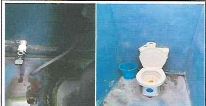
Foto 4: Cambio de accesorios del inodoro ya que no funciona.
