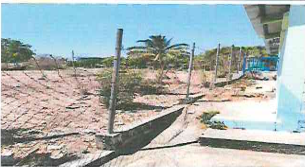
Foto 3: Reemplazar malla metalica por block en muro perimetral, deteriorado por el ganado que se encuentra en la colindancia.
