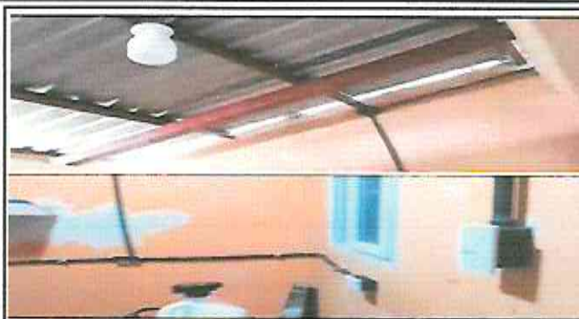
Foto 8: Instalacion electrica en area de cocina, Tomacorriente, Interruptor e iluminacion.
