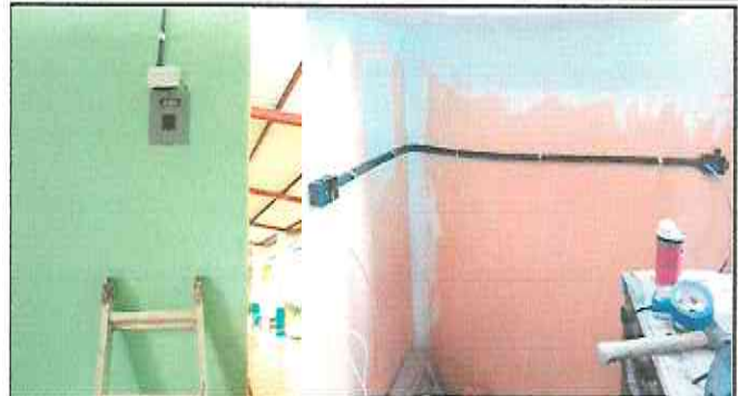
Foto 8: Instalación eléctrica en área de cocina, Tomacorriente, Interruptor e iluminación.
