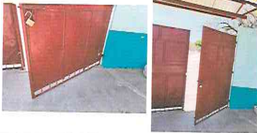
Foto 5: Sustituir porton principal ya deteriorado.
