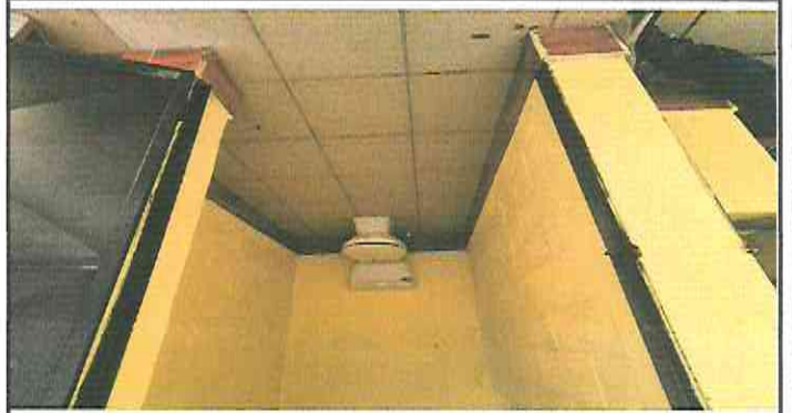
Foto 1: Sustitución de piso de los sanitarios, se encuentra manchado y deteriorado en los cuatro sanitarios existentes.
