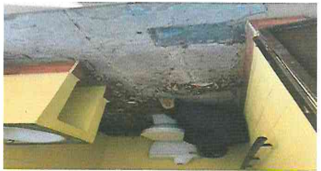
Foto 1: Sustitución de piso de los sanitarios, se encuentra manchado y deteriorado en los cuatro sanitarios existentes.
