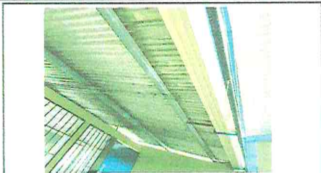
FOTOGRAFIA: SUSTITUCION E INSTALACION DE LAMINA, POR LAMINA TROQUELADA ALUZINC CALIBRE 26 EN MODULO DE AULAS
