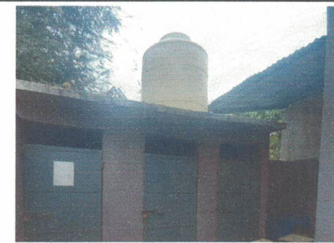
Foto 6: Cambio de Accesorios tales como: Flote, Valvulas Plasticas y Subida y Bajada independiente , para el Deposito de Agua Existente.
