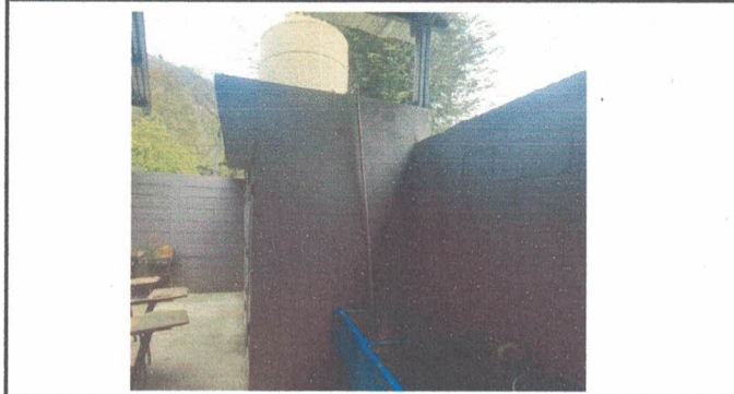
Foto 7: Debe instalarse Caja para Valvulas, Llave Cheque, Cambiar Chorro e Independizar la Subida de Agua al Deposito de la Bajada de manera Individual para ambas.
