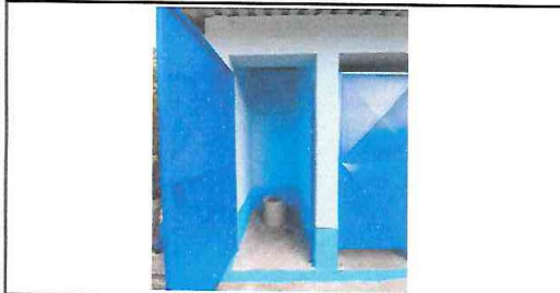
Foto 9: Reparación De Taza Prefabricada de Concreto para Letrina de Hoyo Seco (2 Unidades).
