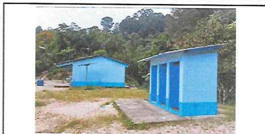
Foto 10: Reparación de Cubierta de Techo de SERVICIO SANITARIOS(LETRINAS). Debe Removerse la Lámina de Asbesto cemento para darle Mantenimiento a la Estructura Existente y Luego Sustituir Lámina Troquelada C26 Legítima. Retiro y Sustitución de Puertas de Metal. Suministro de Pintura Latex + AULA PURA AL FONDO.
