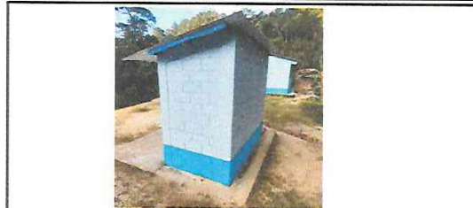
Foto 8: Finalizadas las Actividades de Remozamiento, (VISTA PANORAMICA POSTERIOR DE ESCUELA OFICIAL RURAL MIXTA CASERIO CERRO PELÓN, ZACAPA, ZACAPA. (AULA PURA Y SERVICIOS SANITARIOS (LETRINAS)) Requiere Inversión.
