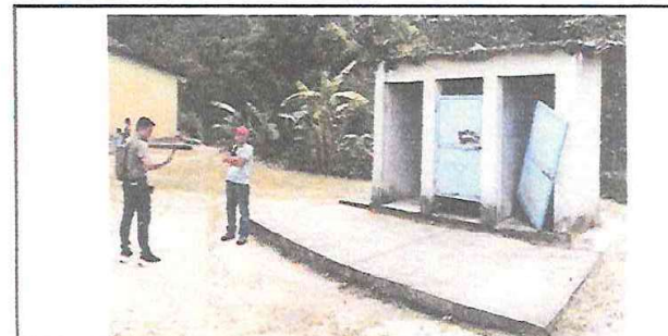
Foto 12: Reparación de Cubierta de Techo de SERVICIO SANITARIOS(LETRINAS). Debe Removerse la Lámina de Asbesto cemento para darle Mantenimiento a la Estructura Existente y Luego Sustituir Lámina Troquelada C26 Legítima. Retiro y Sustitución de Puertas de Metal. Suministro de Pintura Latex.
