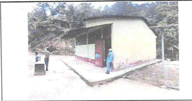
Foto 2: Reparación de Cubierta de Techo de AULA PURA. Debe Removerse la Lámina de Asbesto cemento para darle Mantenimiento a la Estructura Existente y Luego Sustituir Lámina Troquelada C26 Legítima, Retiro y Sustitución de Puerta y Balcones. Suministro de Pintura Latex.
