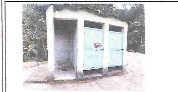
Foto 11: Reparación de Cubierta de Techo de SERVICIO SANITARIOS(LETRINAS). Debe Removerse la Lámina de Asbesto cemento para darle Mantenimiento a la Estructura Existente y Luego Sustituir Lámina Troquelada C26 Legítima. Retiro y Sustitución de Puertas de Metal. Suministro de Pintura Latex.
