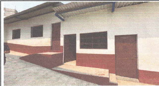
FABRICACION E INSTALACION DE BARANDA (PASAMANOS) DE TUBO HG Y FABRICACION E INSTALACION DE BALCON DE HIERRO EN VENTANA DE COCINA
