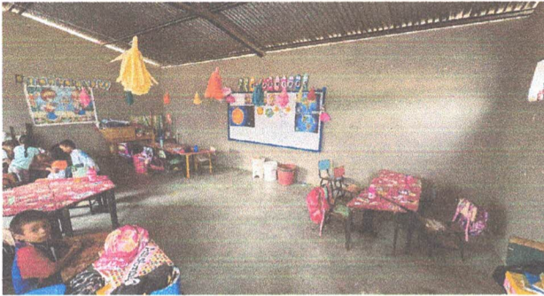
INSTALACION DE UNIDADES DE LUZ, PINTURA EN MUROS INTERIORES E INSTALACION DE CIELO FALSO DE PVC COLOR BLANCO DE AULA 2
