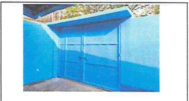
Foto 4: Portón que se le brindó mantenimiento, sustitución de chapa y soporte de concreto finalizado.
