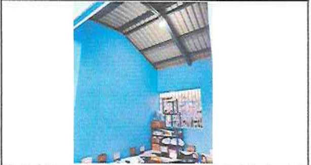
Foto 2: Salón donde se agregó una de las dos unidades de iluminación.
