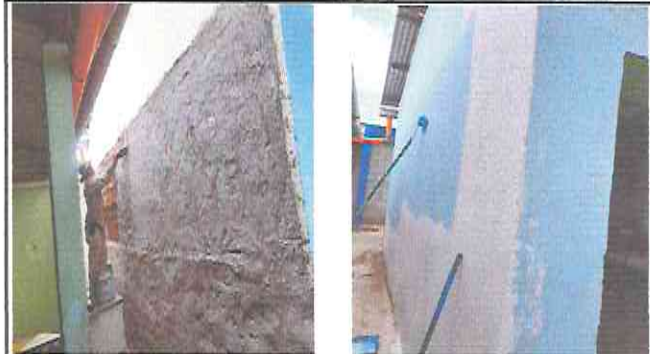
Foto 2: Sustitución de repellos y elaboración de repellos y cernidos en parte lateral izquierda aula 1.
