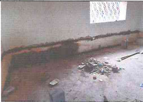
Foto 3: Sustitución de piso de torta de concreto e instalación de piso cerámico aula 1.
