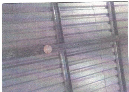
Foto 13 : Sustrucción de lamparas
