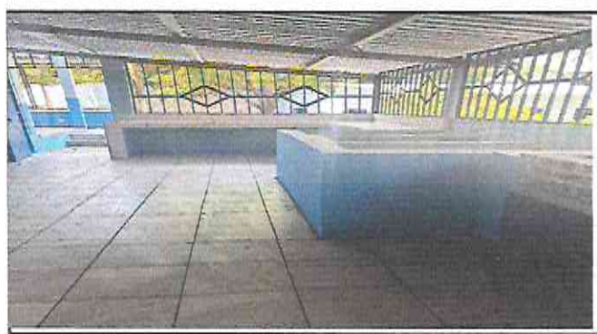
Foto 4: sustitucion de ventanas por balcones en cocina
