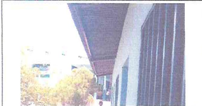
Foto 3: Posteriormente al Mantenimiento a estructura de techo e instalación de Cubierta de Lamina Troquelada Aluzinc para 2 AULAS. Debe Instalarse Pezcantas, Canal Metalico y 2 Bap.
