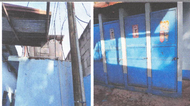
Foto 1: Reparación y mantenimiento del servicio de agua que abastece la pila y los sanitarios.
