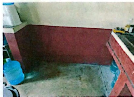
Foto 4: mueble de concreto para preparación de alimentos
