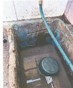
Foto 4: Pila en mal estado, necesita sustitución
