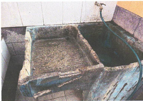
Foto 3: Pila en mal estado, necesita sustitución
