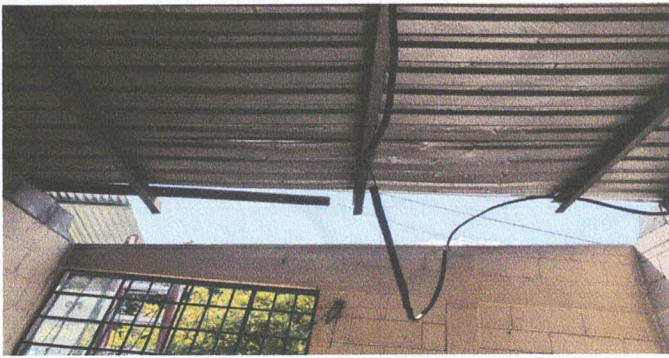
Foto1: Techo de cocina en mal estado
