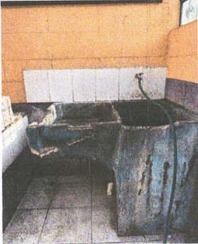
Foto 1: Pila en mal estado, necesita sustitución
