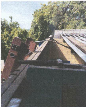
Foto 3: parte de afuera como se visualiza el techo en mal estado
