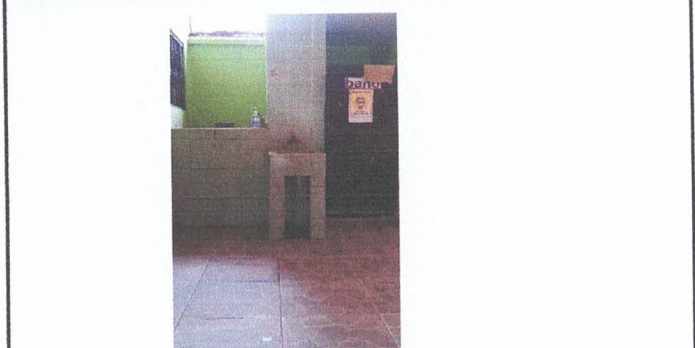
Foto 2: Suministro e instalacion de azulejo en lavamanos de concreto (incluye demolición del azulejo existente)
