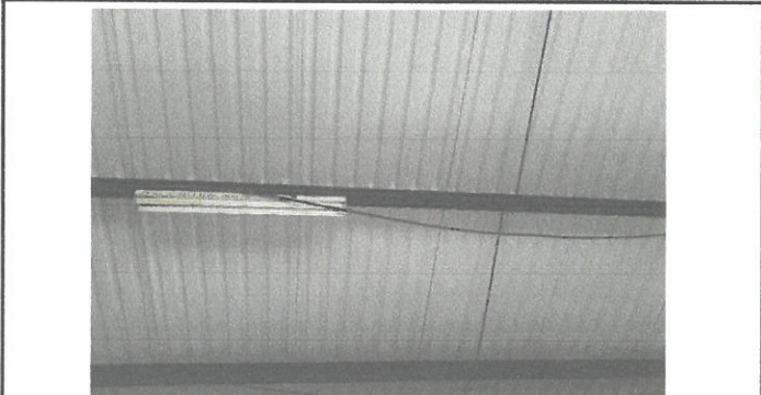
Foto 4: Vista de area de sistema eléctrico
